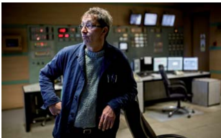
Sárközy László már csak egyedül felügyeli a konzerválási munkálatokat az egyik áramtermelő turbínához tartozó vezérlofteremben
